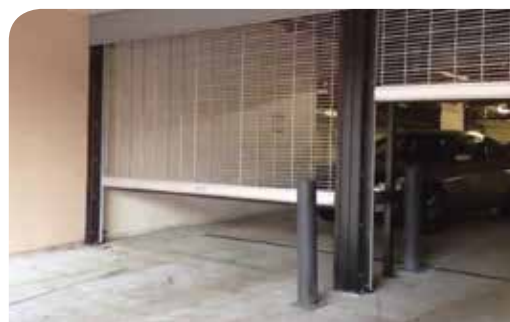
Rester coincé derrière sa porte de parking ne devrait jamais arriver (contrat d'entretien obligatoire)
